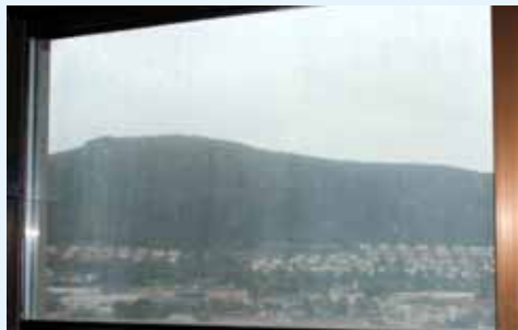
UTSIKT SENTRALBLOKKA: «Langt vekke-utsikt» frå eit pasientrom i Sentralblokka. Vindauga i sengepostområda i Sentralblokka er skjemma av avleiring frå betongen i fasadeplatene, som er etsa inn i vindauga.
